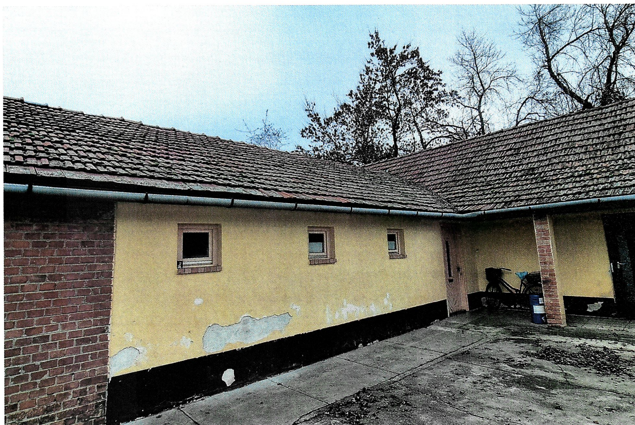
A sporttelep kisegítő létesítménye a tetőfelújítási munkálatok megkezdése előtt
